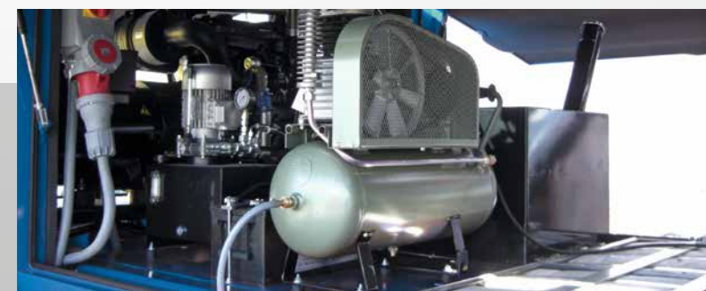
Compresseur pour le nettoyage
