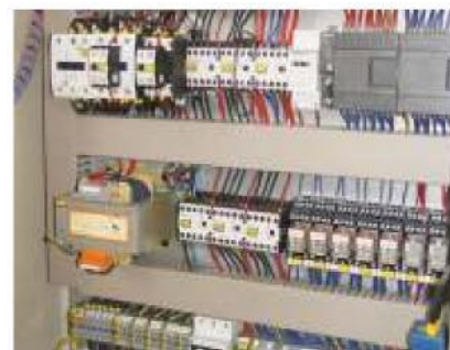
Coffret électrique avec automate
